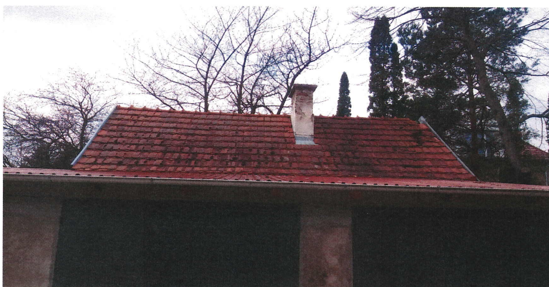
Fot. 5- Miejscowe braki dachówek, braki spoinowania komina
