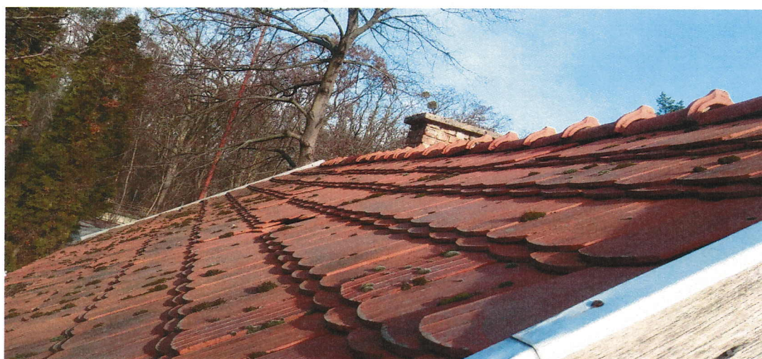
Fot.4- Uszkodzone dachówki, odparzony tynk na kominie
